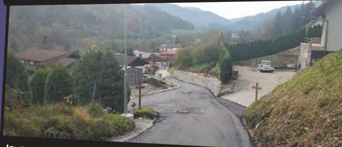
Javna pot Mariborska cesta –Kaiser - Večina del pri obnovi javne poti na Mariborski cesti z novim vodovodom v dolžini okoli 360 metrov je bila izvedena tekom lanskega leta. Izgradnja kanalizacije je bila izvedena v sklopu izvedbe projekta »Izgradnja sekundarne kanalizacije v Aglomeraciji Vič«. Vrednost investicije znaša okoli 480.000 €. (MS)
